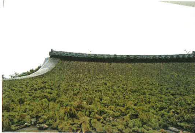
▲屋根背面（鳥が屋根葺き材を引き抜いた跡）
